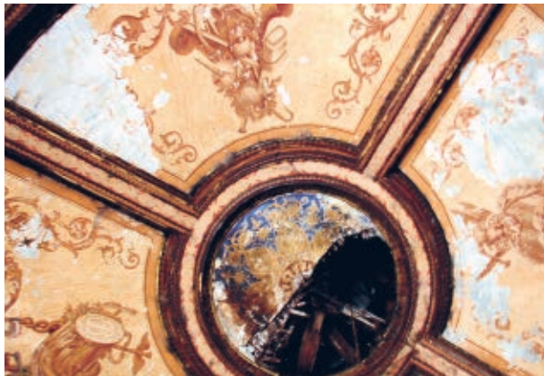
Deckenausschnitt mit Bauschäden.
